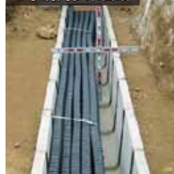
U字溝内多条管路
