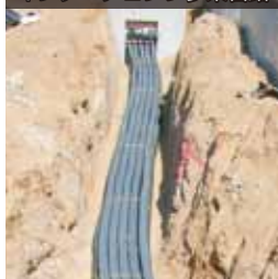
インターチェンジ多条管路
